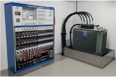
TS Storchenacker - Trafo und Niederspannungsverteilung
