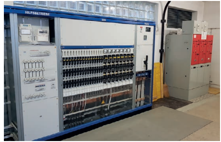
TS Kaabach - Niederspannungsverteilung
