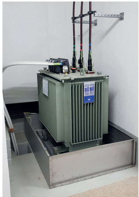
TS Kaabach - Trafo
