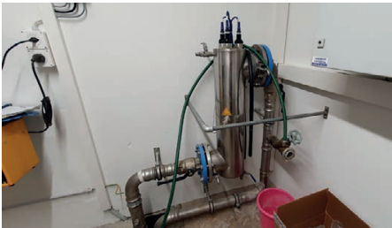
UV Anlage im Lätten
