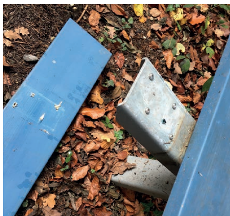
Beim ersten Vorfall wurde die Bank aus den Verankerungen und die Rückenbretter ausgerissen
