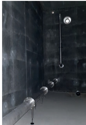
Reservoir mit Zulauf
