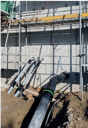
Aussenansicht Hauptleitung von und zum Netz
