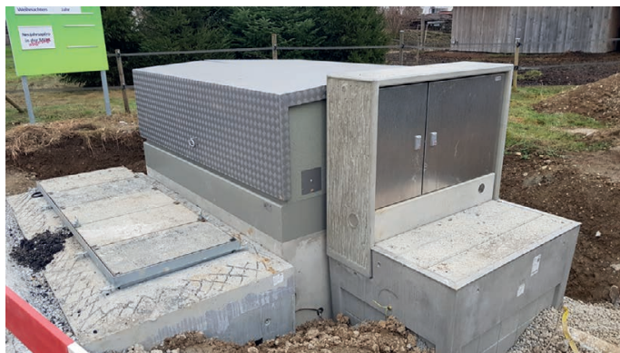
Neue Transformatorstation an der Hauptstrasse in Lommis
